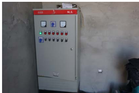
地埋一体式污水处理设施自动控制系统
